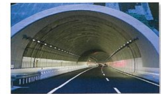
高速道路 トンネル用照明器具
