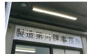
事務所軒下 防湿・防水形照明器具
